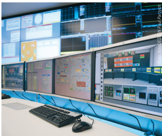
Blick in den Kontrollraum, von dem aus der Beschleuniger gesteuert wird.
